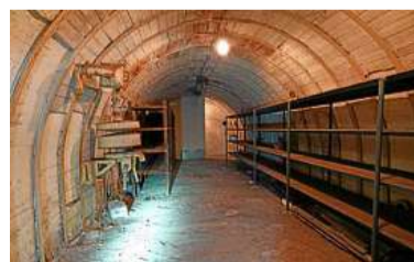
Einer der beiden Lüfter von 1944 ist noch erhalten.
