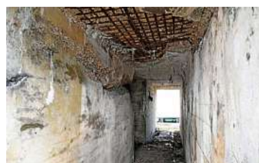
Die Folgen eines Bombentreffers sind noch deutlich zu sehen.
